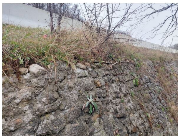
Рис. 6. Наползание грунта на подпорную стену
