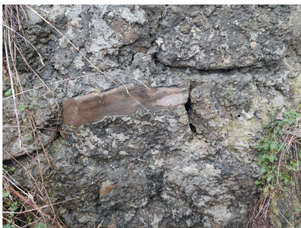
Рис. 5. Локальное разрушение заполнения швов кладки
