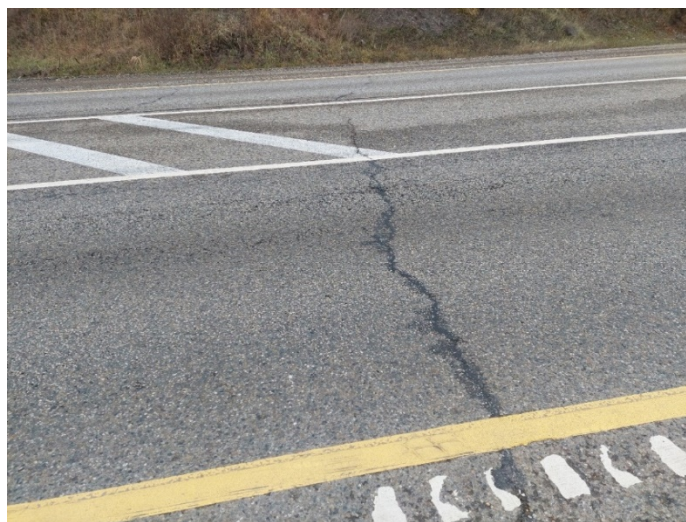
Рис. 7. Трещины в покрытии автомобильной дороги
