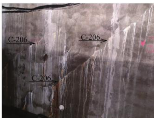
Рис. 4. Сквозные трещины в наружной стене Fig. 4. Transparent cracks in the external wall
