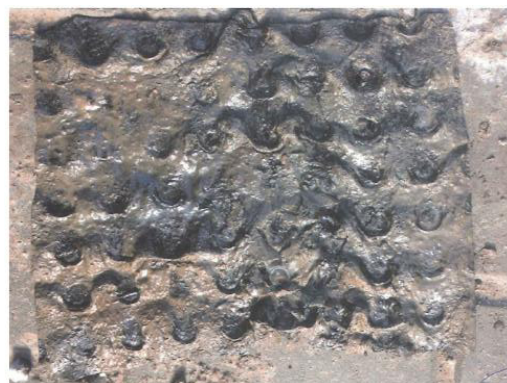
Рис. 5. Фото вырезанного фрагмента гидроизоляции всплывшего паркинга Fig. 5. Picture of the fragment of waterproofing hydro isolation of parking
