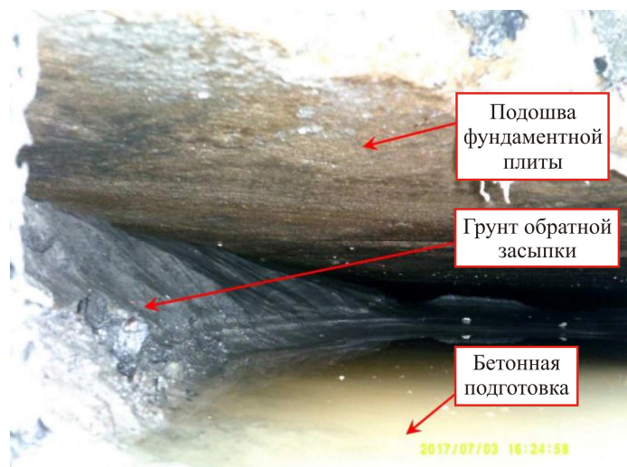
Рис. 8. Продольное фото пространства под подошвой фундаментной плиты всплывшего паркинга
