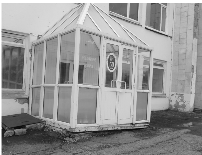
Рис. 5. Опасные деформации эксплуатируемого здания без укрепления фундамента Fig. 5. The operated building continues to be dangerously deformed without strengthening the foundation
