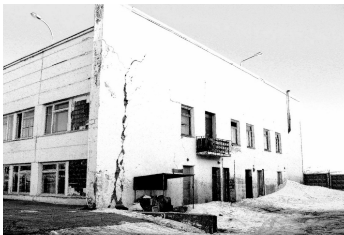
Рис. 4. Опасные повреждения торца пассажирского терминала Fig. 4. Dangerous damage to the end of the passenger terminal
