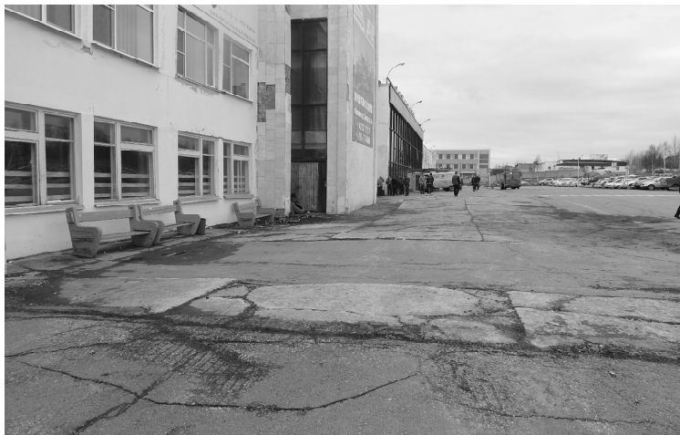
Рис. 3. Деформации покрытия площади перед аэропортом Fig. 3. Deformation of the area in front of the airport
