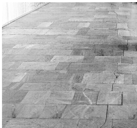
Рис. 6. Продольные трещины в полу по всему зданию из-за просадки проблемных участков фундаментов Fig. 6. Longitudinal cracks in the floor throughout the building due to the subsidence of the problem areas of the foundations
