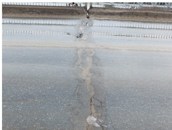
Рис. 4. Трещины в покрытии у шва и над швом, протечки через поврежденное заполнение (мост через р. Ельчик в г. Елец, Липецкой области)
