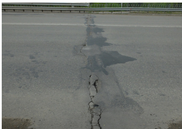
Рис. 1. Разрушение асфальтобетонного покрытия в зоне деформационного шва (путепровод в г. Невинномысске Ставропольского края) Fig. 1. Destruction of asphalt concrete surface in the zone of the deformation joint (overpass in Nevinnomyssk, Stavropol territory)
