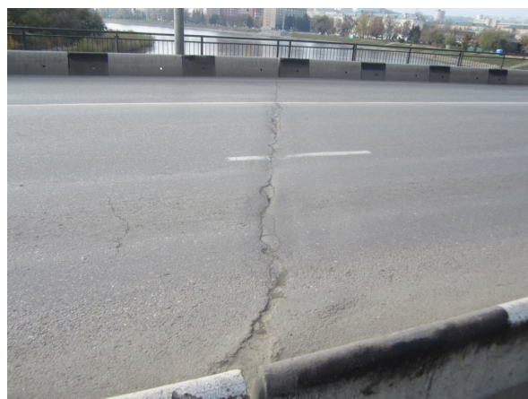
Рис. 2. Трещины, разрушение покрытия в зоне деформационного шва (мост в г. Пензе) Fig. 2. Cracks, destruction of the coating in the zone of the deformation joint (bridge in Penza)
