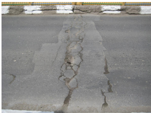
Рис. 3. Разрушение покрытия, сеть трещин, нарушение герметичности, пролом в зоне деформационного шва (мост в г. Грязи, Липецкой области)
