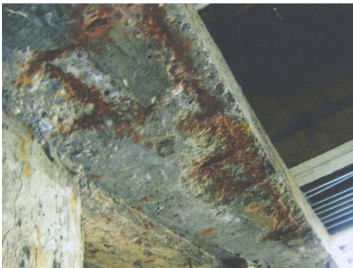
Рис. 2. Замокание, разрушение бетона в нижней части насадки опоры с обнажением и интенсивной коррозией арматуры из-за повреждения гидроизоляции (мост через р. Липовка по ул. Фрунзе в г. Липецке)
