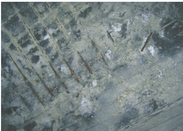
Рис. 3. Разрушение защитного слоя бетона с оголением и коррозией арматуры в плите проезжей части из-за повреждения гидроизоляции (мост через р. Липовка по ул. Фрунзе в г. Липецке)
