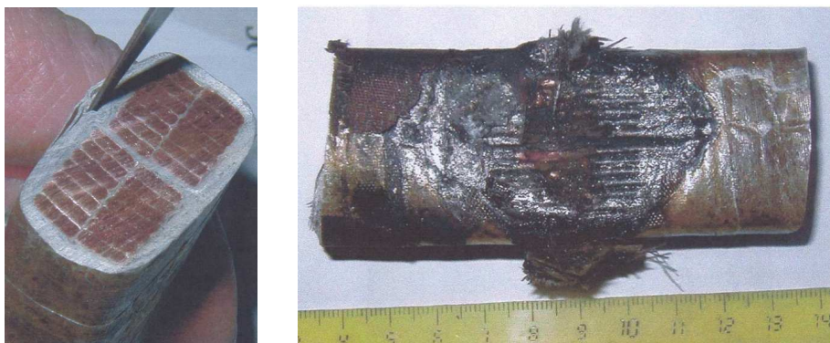
Рис. 2. Фрагменты стержня обмотки поврежденного электродвигателя СТД-12500-2 ЭГПА 1 КЦ «Ямбург-Елец-2» КС-24 Сеченовская
