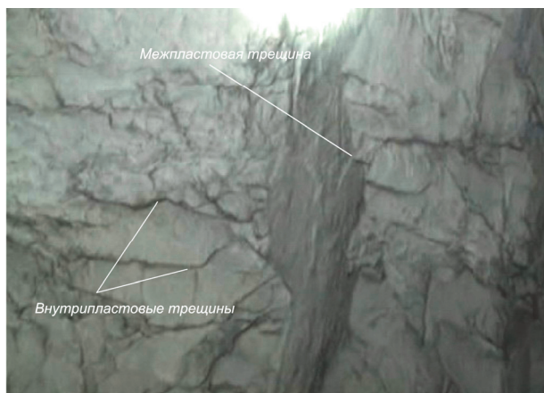
Рис. 2. Общий вид трещиноватости массива песчаника
