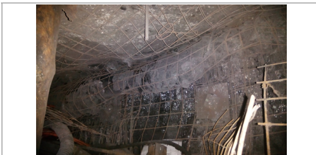
Рис. 7. Виды разрушений элементов крепи и пород в вентиляционном штреке 2–7
