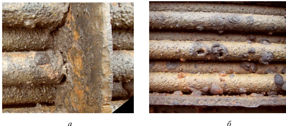
Рис. 4. Коррозионное утонение трубок у перегородок (а) и свищи на трубках (б)
